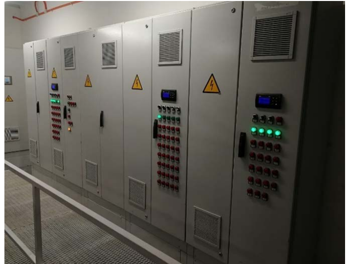
Рис. 4. Система управления транскритической установкой (Metro Солнцево)
