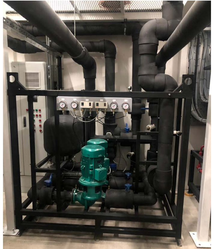
Рис. 5. Насосная станция хладагителя для производственных помещений.
